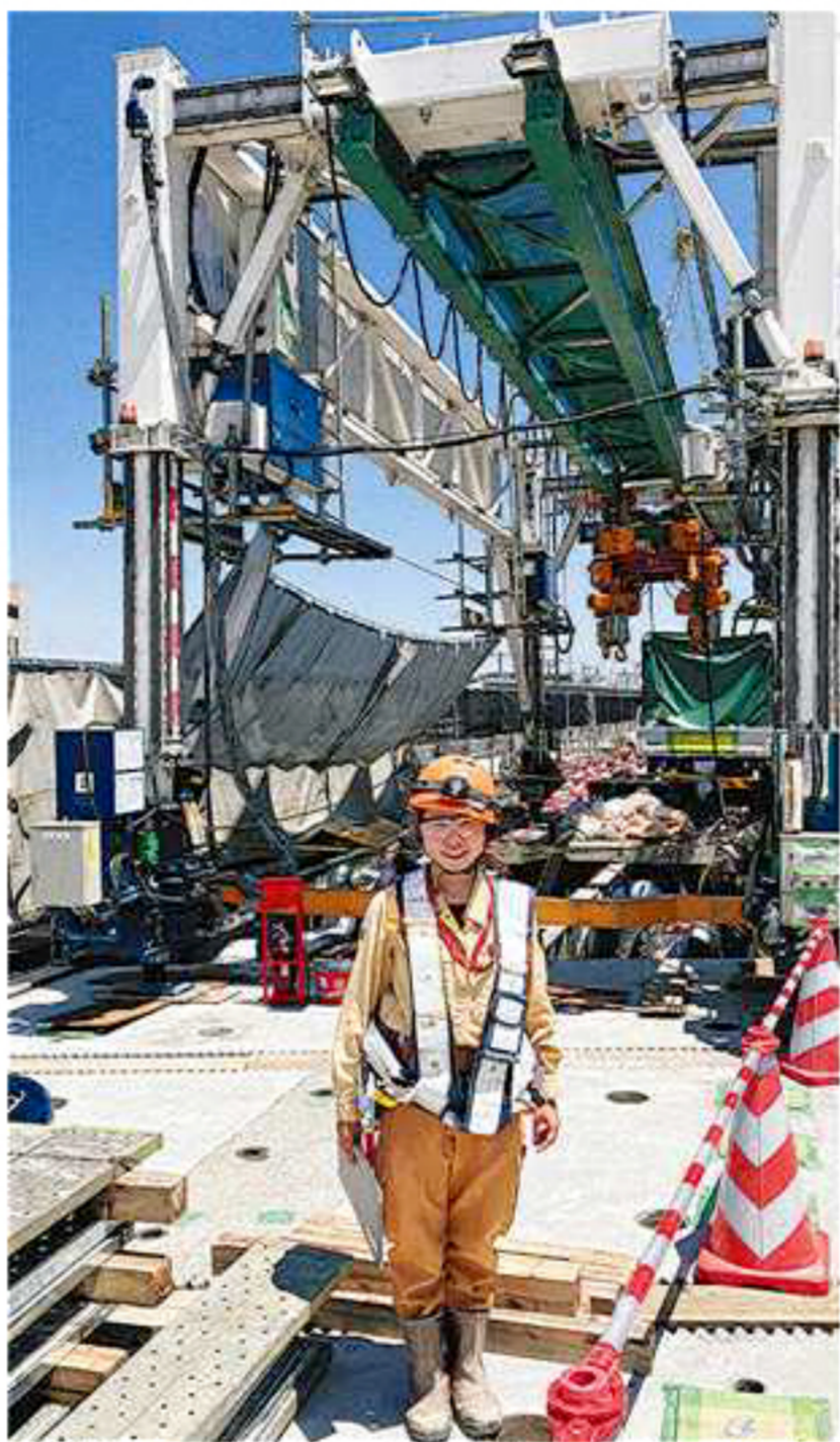
女性の少ない建設現場で働く川上さん。志望とは違う道へ進んだが、3年目の今はやりがいを感じている＝川崎市で（本人提供）
